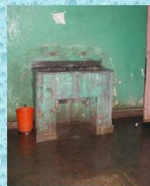
Point d'eau dans une salle d'hospitalisation
